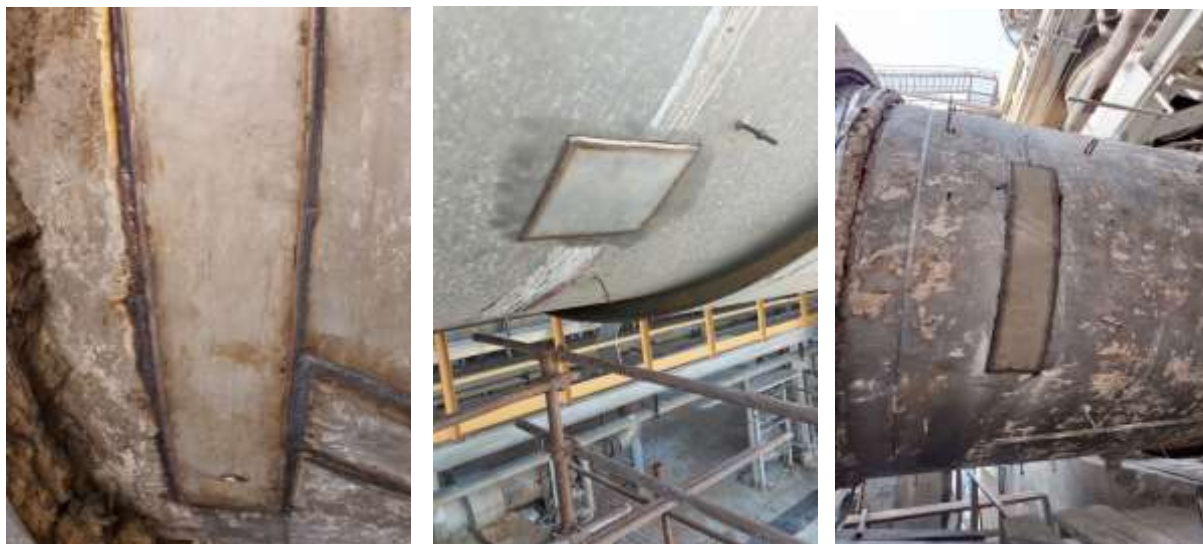
شکل ۵- محل نشستی و ترک روی بدنه، جوشکاری و نصب پد
