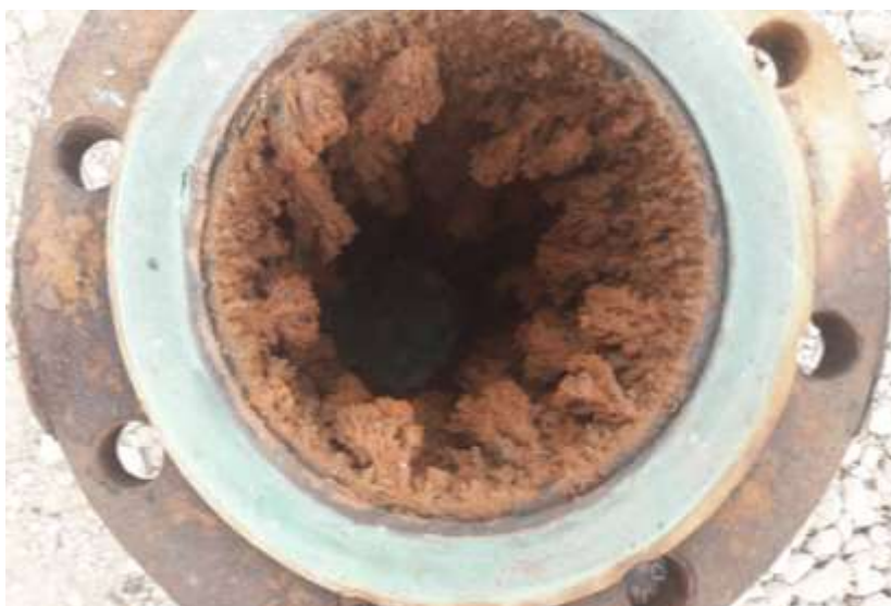
شکل ۱- خوردگی در خط لوله‌ی انتقال آب در اثر ناپایداری آب نمک‌زدایی شده‌ی دریا [10]
